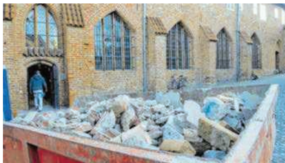
Bereits 2016 sind in der Klosteranlage Baumaßnahmen angelaufen, um das Feuchtigkeitsproblem in den Griff zu bekommen.
