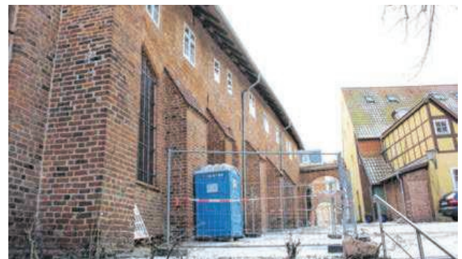
Die Bauarbeiten zur Bestandssicherung im Johanniskloster stehen laut SES-Geschäftsführerin Ronny Planke kurz vor dem Abschluss. Jetzt wird ein Nutzungskonzept für die gesamte Anlage erarbeitet. FOTO: JENS-PETER WOLDT
